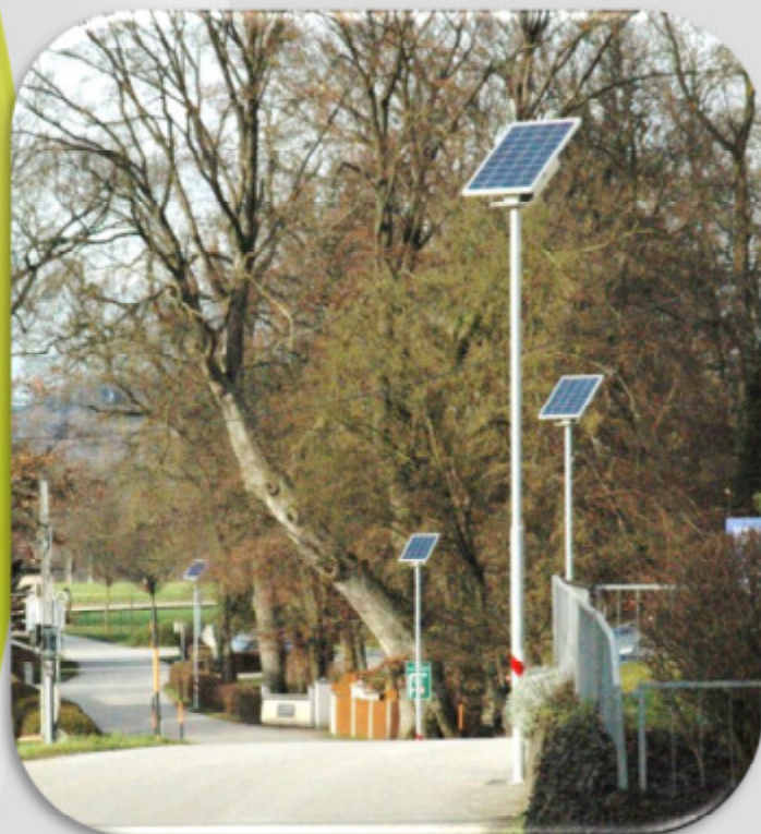
Solarbeleuchtung Gemeinde St. Peter am Hart OÖ, mehr als 70 Stück GAIA 80 S
