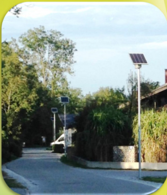
Beleuchtung Gemeinde Jeging OÖ 1000 m Wegbeleuchtung GAIA80 mit spezieller S-Klassen-Optik
